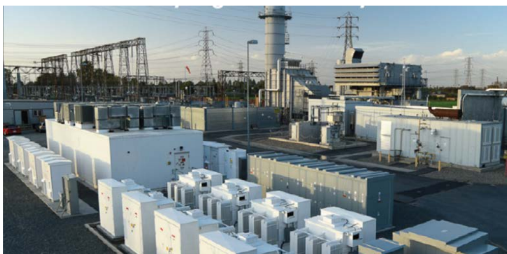
Рис. А1-101-2. Гибрид батареи и газовой турбины в промышленной эксплуатации
