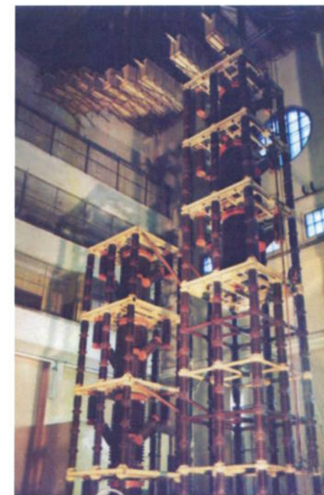
Рис. 5. Испытательная установка постоянного тока 1200 кВ, 0,3 А
