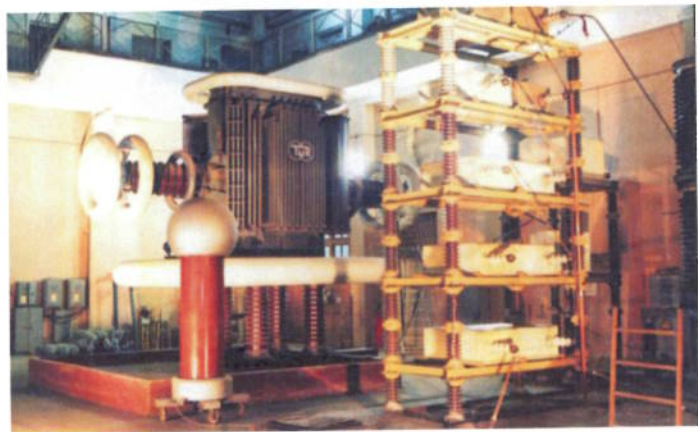
Рис. 6. Комбинированная испытательная установка переменного напряжения 500 кВ, 6 А и постоянного напряжения 500 кВ, 0,3 А
