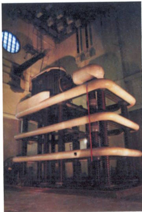
Рис. 4. Испытательный трансформатор 750 кВ, 2 А
