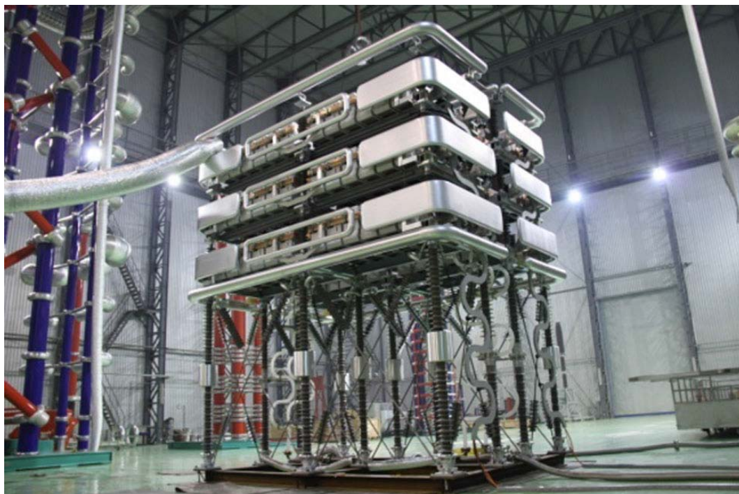
Рис. 2. Вентиль для ММПН \pm 320 кВ 1000 МВт
