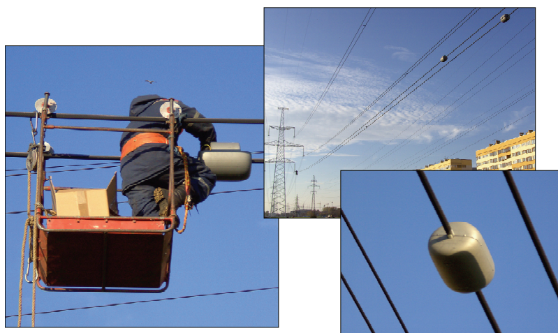
Рис. 4: Варианты установки устройства мониторинга температуры провода на ВЛ 110 кВ, 220 кВ и 330 кВ
