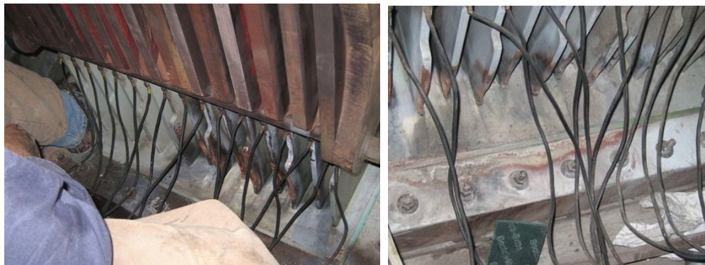
Рис. 11: Фотографии вторичной обмотки после повреждения. В результате очень быстрого отключения повреждения минимальны
