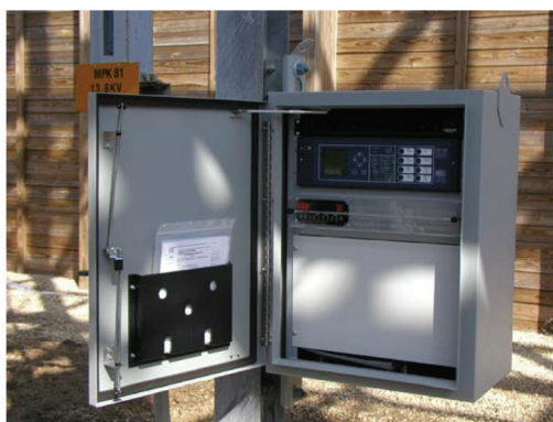
Рис. 7: Интеллектуальное автоматизированное и распределенное устройство, установленное локально с целью защиты, управления и контроля сетевой аппаратуры
