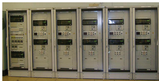
Панель на подстанции Strathaven
