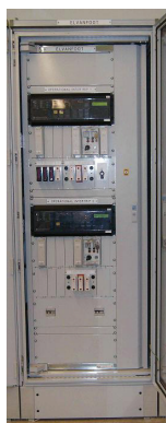
Панель на подстанции Elvanfoot
