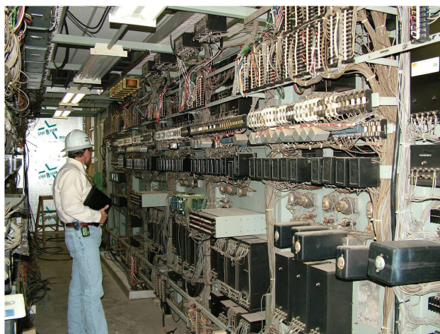
Рис. 4: Панель электромеханических реле с монтажом на задней панели
